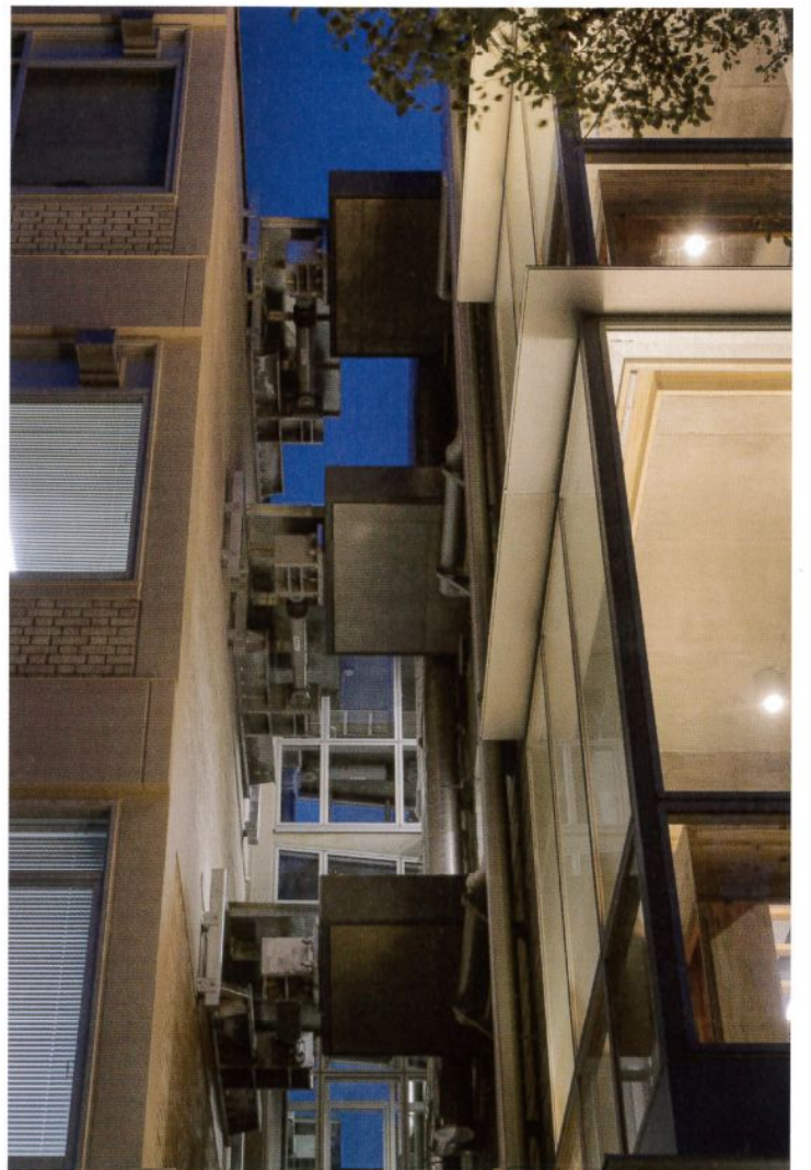
■既存棟と増築棟間の制振ダンパー
